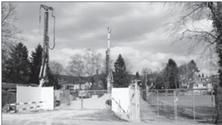
A5-Versuchsbaustelle im Bieler Mühlefeld: Folgen doch verheerender?
