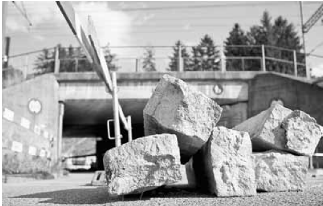
Le chemin Mettlen a été en travaux cet été, afin d'y changer le régime de circulation. ARCHIVES
