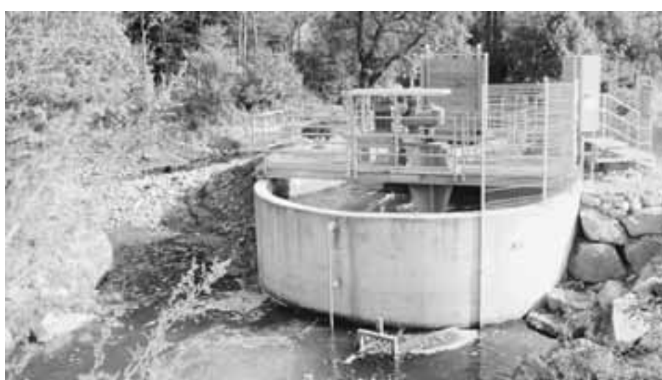
La première centrale hydraulique à tourbillons se trouve à Schöffland, en Argovie. LDD
